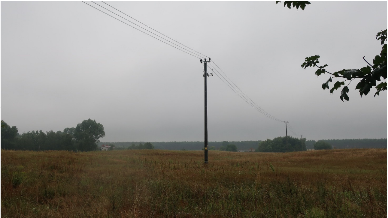
Ryc. 6. Linia elektroenergetyczna 15kV na terenie objętym planem
